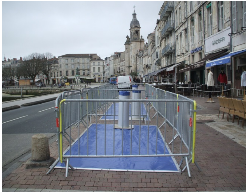
Système de bâche plastifié au Quai Duperré à La Rochelle
