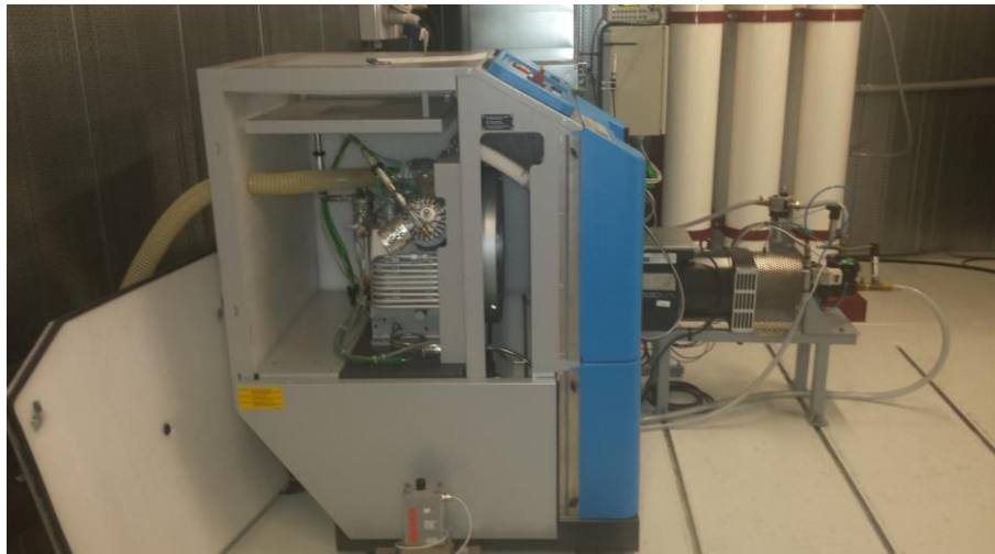
Figure 13 – La vue de côté du compresseur
