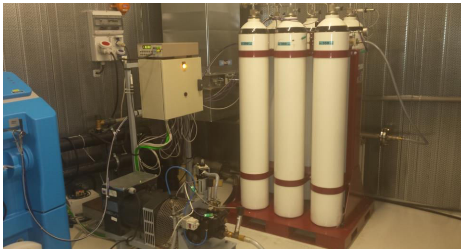
Figure 14 – La vue de côté du réservoir de stockage
