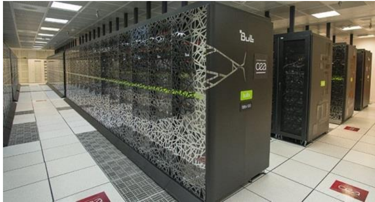
Figure 2 : Supercalculateur TERA100, en service depuis 2010 sur le centre CEA-DAM Ile de France [2].
