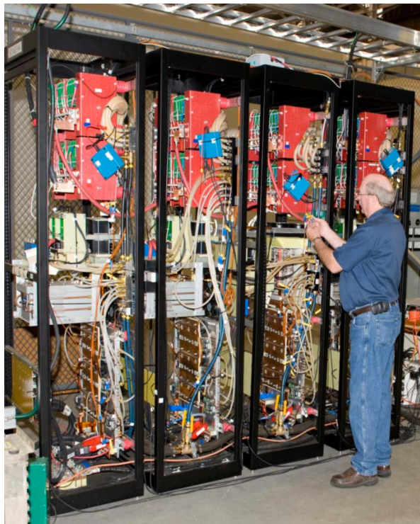
FIGURE 1.18 – Sous-station 1MV A à découpage abaissant la tension de 13.8kV à 465/\sqrt{3}V [51].
