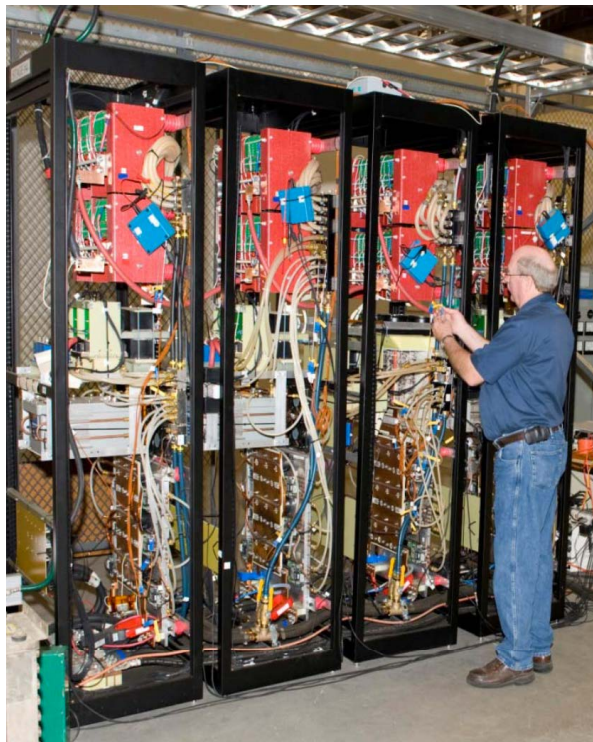
FIGURE 1.18 – Sous-station 1MV A à découpage abaissant la tension de 13.8kV à 465/\sqrt{3}V [51].
