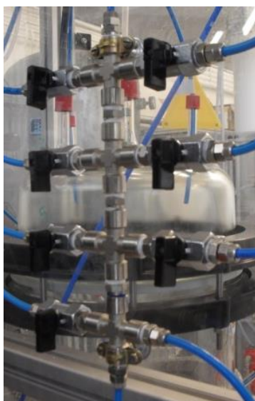
Figure E.10. Vue de la centrale de piquage
