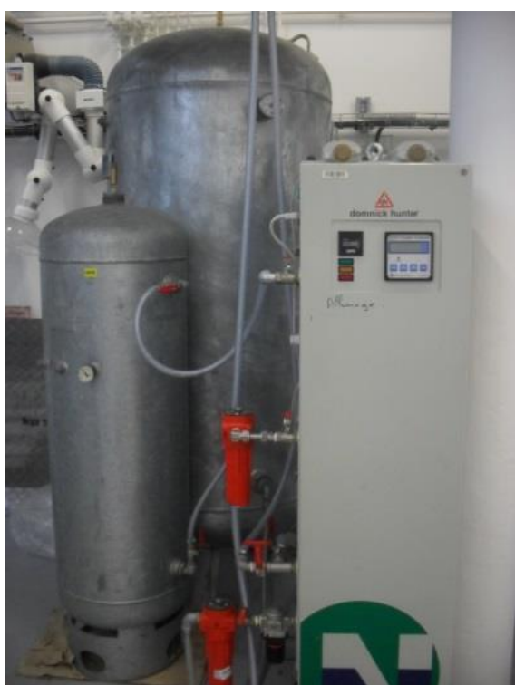
Figure E.5. Vue de face du générateur de diazote
