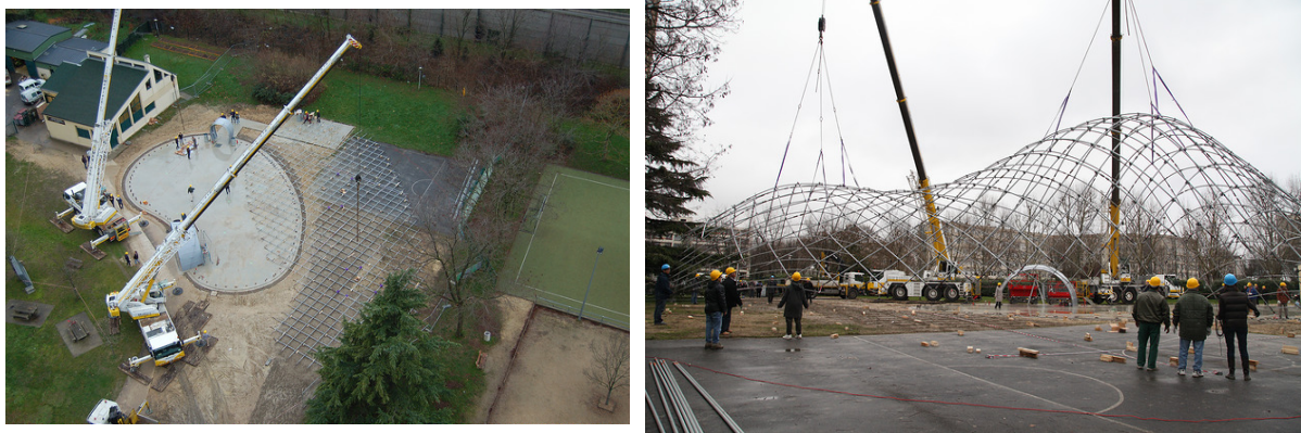
(a) Grille de poutres assemblée sur le sol [20] (b) Déformation élastique de la grille de poutres [19]
