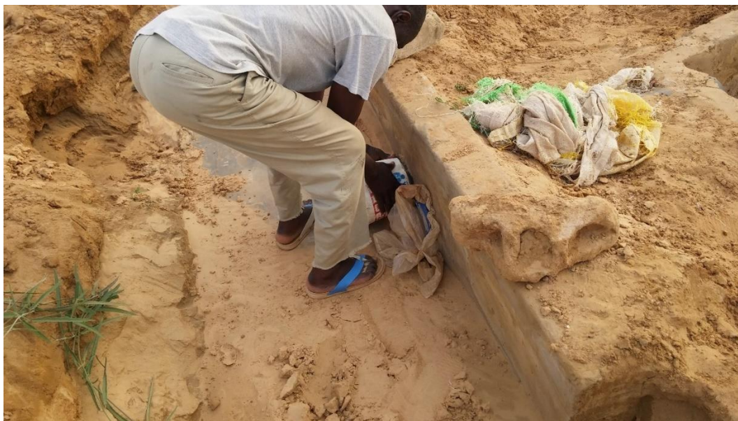
Photo 23 : Bricolage d'un tuyau de canalisation par un seau usagé et par des sacs en plastique.
