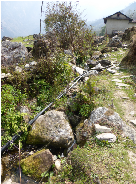
(a) Conduite d'acheminement.
