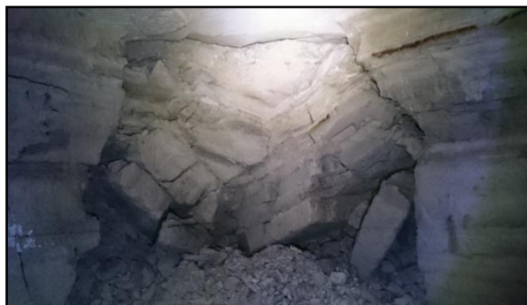
Figure 3-9 Éboulis d'un fontis dans la zone nord dans la carrière de la Brasserie (Zone I)
