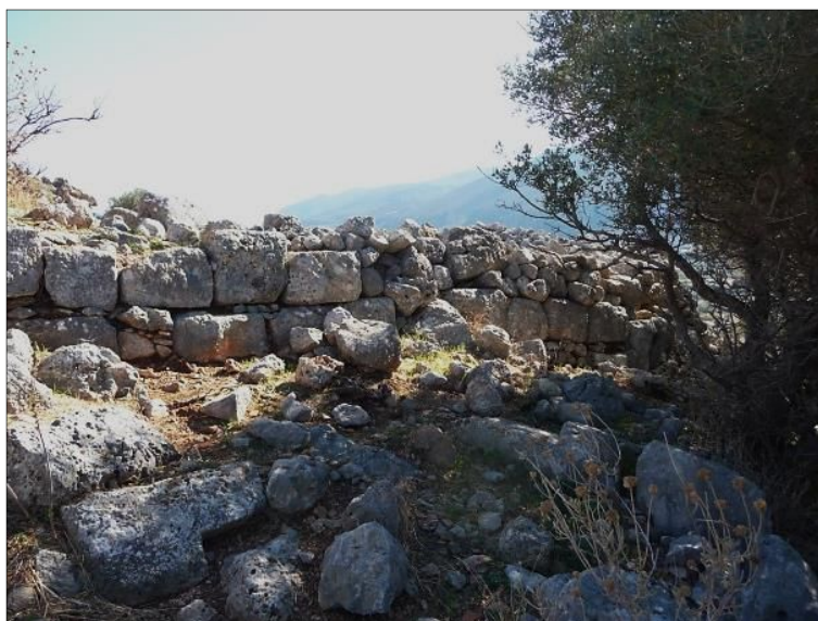
Fig. 15 - Parement externe de la courtine 21 avec les traces de réparations avec des pierres de tout-venant, vue vers le sud-est, cliché Guintrand 2012
