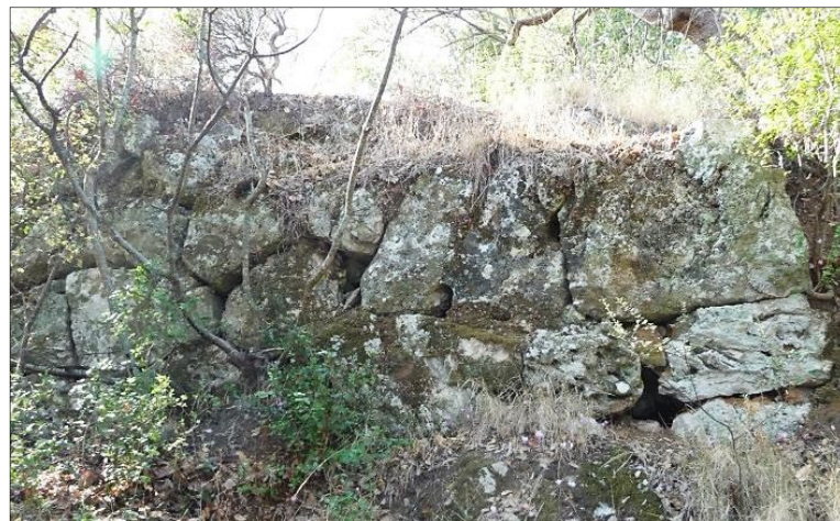
Fig. 6 - Face externe de la courtine 3 (rempart est), vue vers l'ouest, cliché Guintrand 2012
