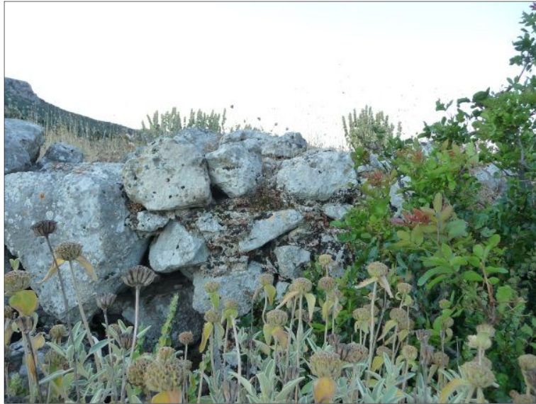
Fig. 3 - Face externe du mur nord avec réparation médiévale, vue vers le sud, cliché Guintrand 2015
