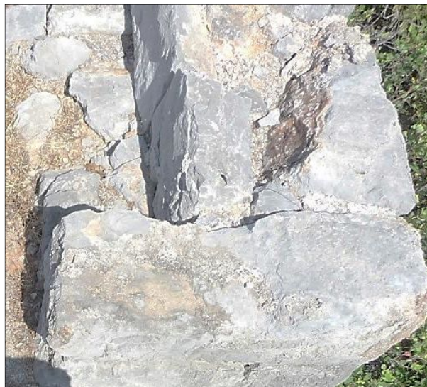
Fig. 7 - Mortier entre les blocs du mur sud de la tour 9, vue vers l'est, cliché Guintrand 2015
