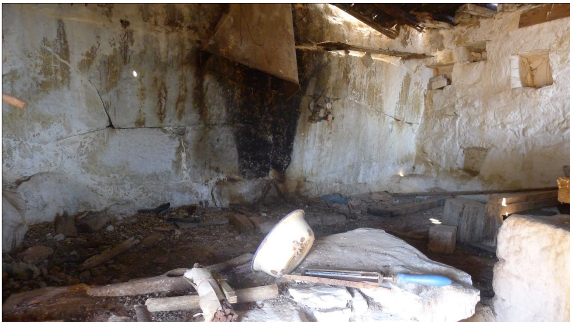
Fig. 6 – Parement externe de la courtine 15 servant de mur arrière pour la bergerie, vue vers l'est, cliché Cl. Balandier 2015
