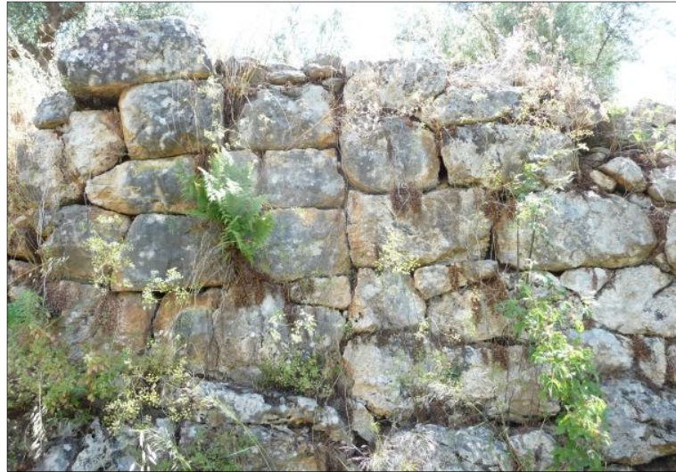
Fig. 5 - Coup de sabre dans le mur du tronçon 4, vue vers le sud, cliché Guintrand 2015
