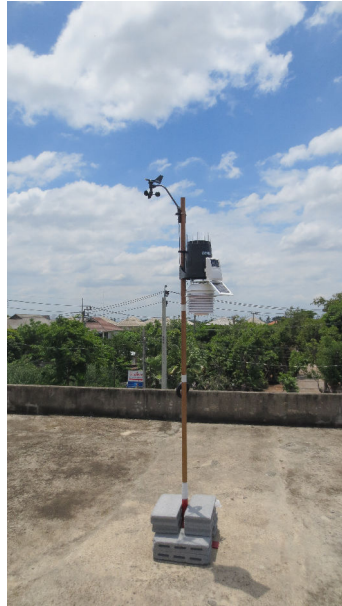
FIGURE 107 – Station météorologique installée sur le toit du centre de santé de Thawi Watthana (photo orientée est) (photo : Renaud Misslin, 2015)
