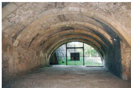
Figure 120 : Vue de la salle ouest de la porte des Allemands avant les rénovations de 2013
