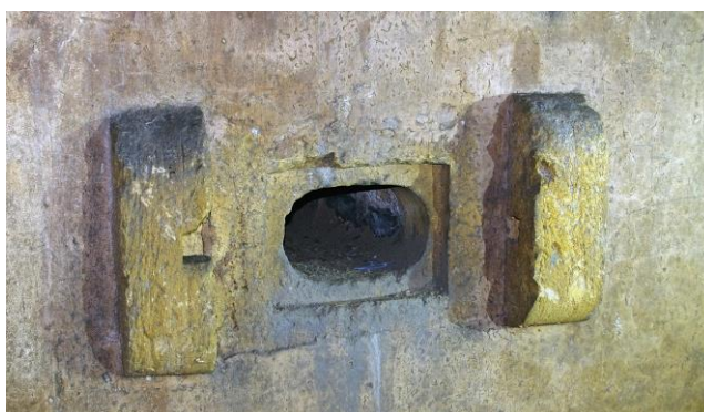
Figure 84 : Détail d'une des canonnières avec les supports latéraux dans la tour d'Enfer
