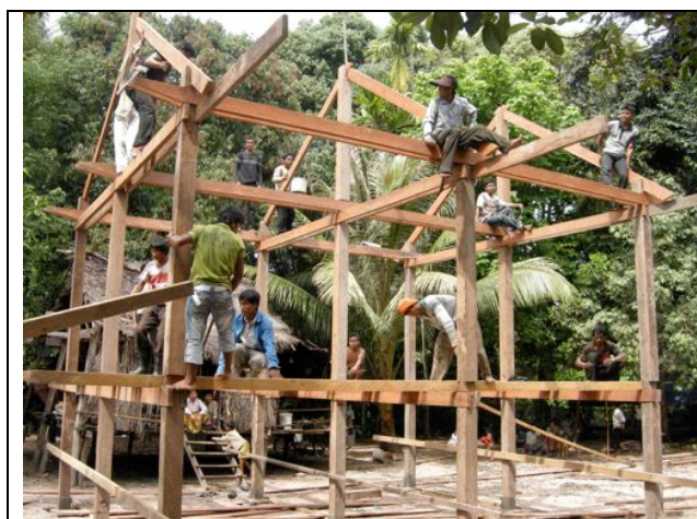
Fig. 22 : Premier jour de la construction d'une maison. Assemblage de la structure en bois avant la pose de la panne faitière. Village d' Anlong Thom, Phnom Kulen ( Photo F. Luco février 2009).
