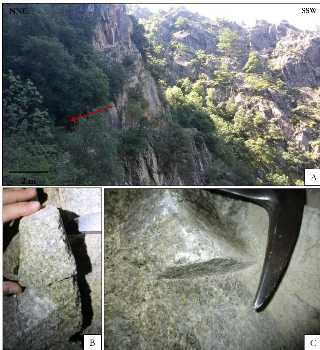
Figure 5-16 : A – Vue du site du tunnel de Nyer, surplombé par une vingtaine de mètres de roches cristallines sus-jacentes. La flèche représente la première entrée du tunnel. En revanche, l'écrantage latéral, bien que l'angle et l'exposition soit favorable à une faible réception du rayonnement cosmique, est sujet à caution car moins d'un mètre de matériau est présent. Par ailleurs l'épaisseur de roches sus-jacentes n'a pas pu être déterminée. B – Photographie du prélèvement ASAR016_002, de nature granitique. C – Photographie du prélèvement ASAR016_003, de nature granitique.
