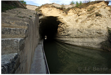
(a) Tunnel-canal de Malpas (photographie issue du site du canal du midi)
