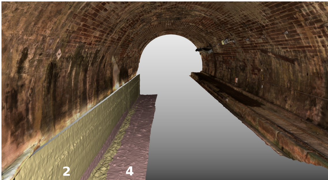
FIGURE 3.25 – Illustration des maillages subaquatique de l'entrée du tunnel côté Niderviller générés grâce au calcul effectué avec Micmac. Seuls les passages 2 et 4 sont référencés à ce jour. Les suivants seront disponibles très prochainement. La visualisation de la partie aérienne est celle produite à l'aide de Photoscan.
