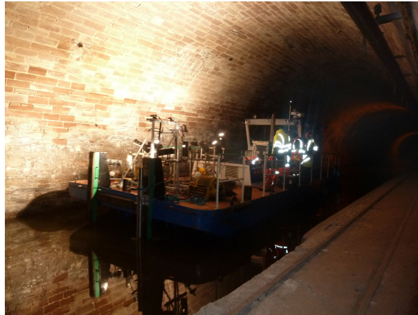
FIGURE 3.13 – Image du système lors de l'expérimentation dans le tunnel de Niderviller.
