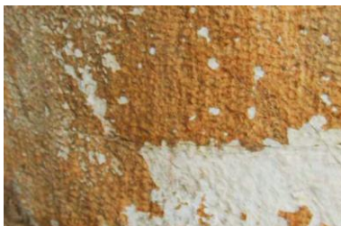
Figure 3 : Couche d'oxalate de calcium sur marbre de l'église San Frediano à Pise (source : Rampazzi, 2004).
