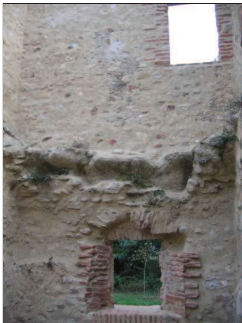
Trace d'arrachement de la voûte de l'abside, mur sud
