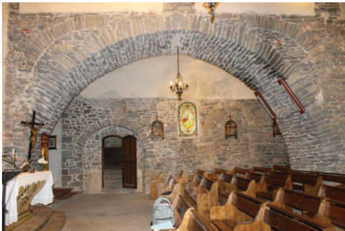
Arcade reliant la nef et le bas-côté méridional, et traces des anciens arcs latéraux
