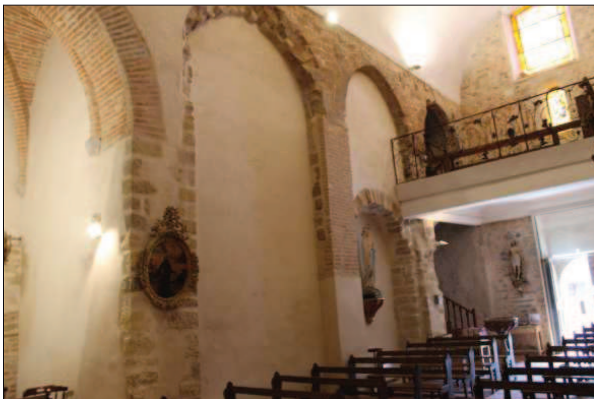
Mur nord de la nef (haut), mur sud de la nef (bas), vus depuis l'est
