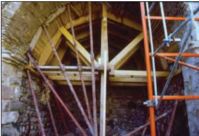
Ill.13 , Sainte-Cécile-de-Cos (le Tech) – Positionnement d’un coffrage pour la restauration de la voûte en plein-cintre de l’abside.
