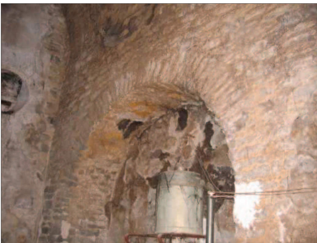
Arc triomphal, vu depuis l'est, en lieu et place de l'ancienne abside (haut), arc latéral est du mur gouttereau méridional (bas)
