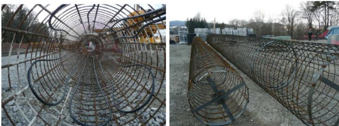
Figure 1.5 – Exemple de l'incorporation du réseau du captage dans le ferrailage des fondations.
