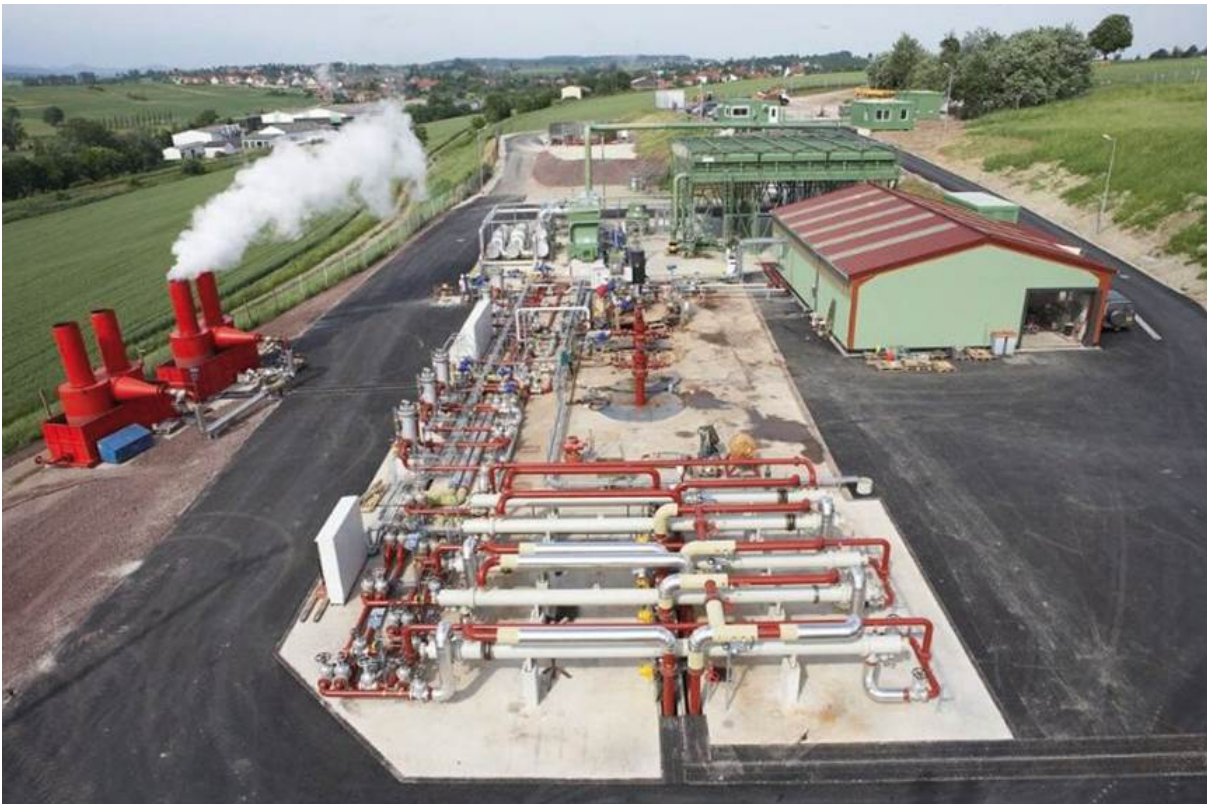
Figure 1.3 – Centrale électrique de Soutz-sous-forêts.
