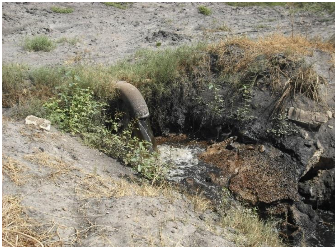
Photo 11-Tuyau d'amenée des eaux résiduaires de la CSS, cliché P.Diop, 2011
