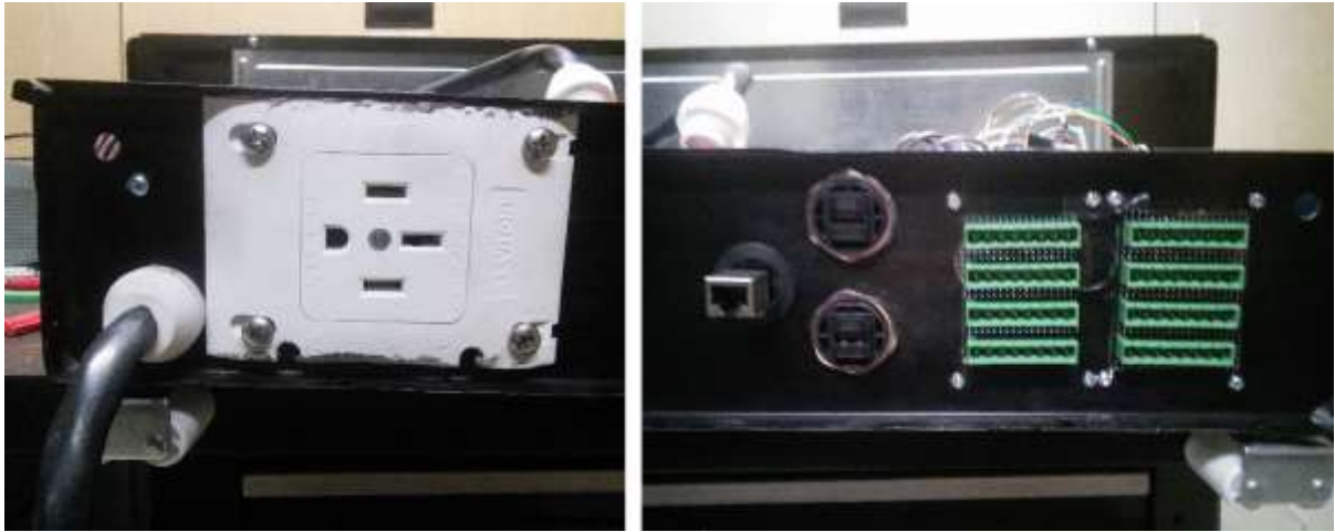
Figure 53 - Photo de l'arrière du tiroir avec (de gauche à droite) la prise triphasée, un bornier pour le câble réseau, deux ports USB et les borniers des capteurs.
