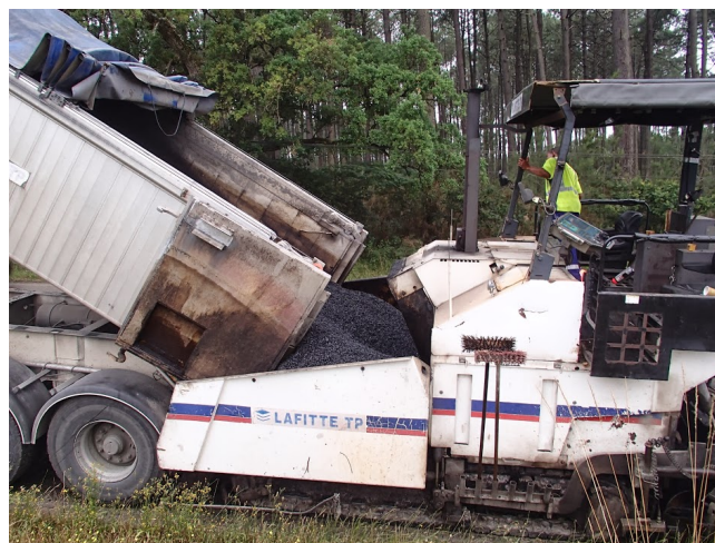
Figure 5 : Camion ravitailleur déversant l'enrobé dans la trémie du finisseur qui le pousse.
