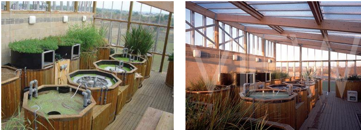
Illustration 19 : Images de la station d'épuration verte à BedZED
