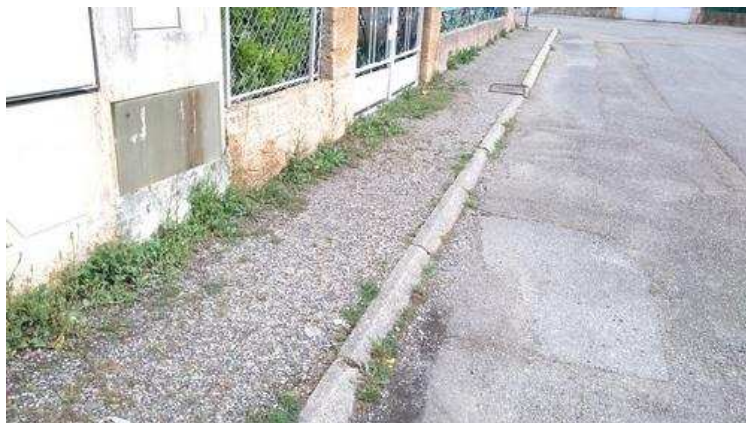
Photographie 18 : Trottoir réalisé par un habitant à Saint Hippolyte du Fort
