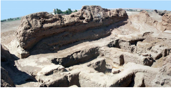
Fig. 36 : Mari. Mur sud de la salle du trône laissant apparaître un sillon destructeur à la base. (©CRAterre, Mahmoud Bendakir, 2004)
