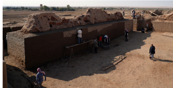
Fig. 37 : Mari. Restauration partielle du mur sud de la salle du trône. (©CRAterre, Mahmoud Bendakir, 2008)
