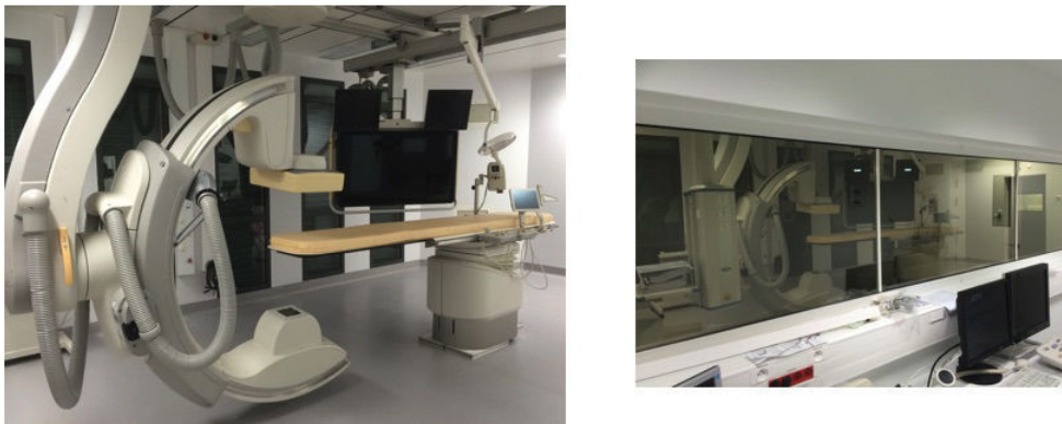
FIGURE 1.16 – Bloc de radiologie interventionnelle. Gauche Salle d'intervention. Droite Salle de contrôle et d'interprétation. CHU de Fort-de-France, Martinique
