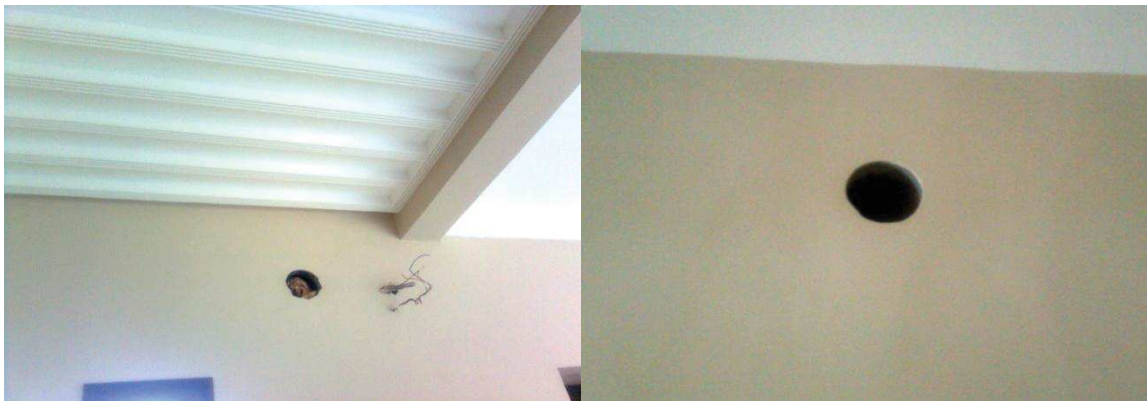
Figure.III.3.a. Bouche de soufflage au grand salon (RDC)
