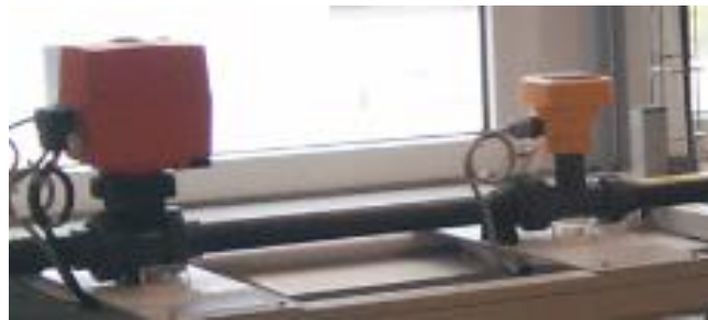
Figure 130 : Vanne de régulation et débitmètre de la voie 1 de la plate-forme CISPI
