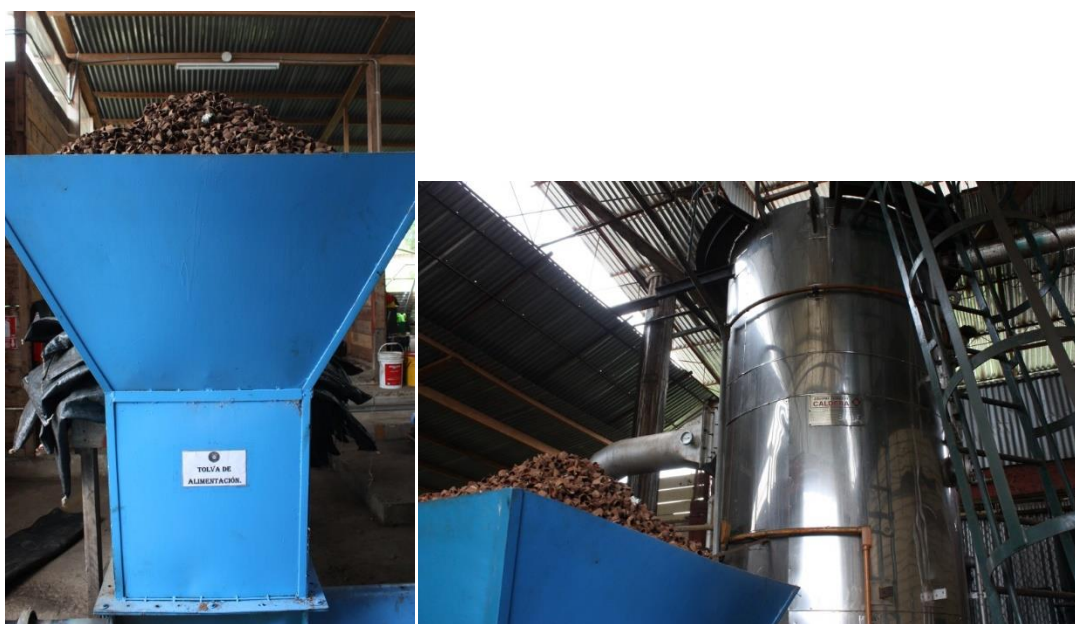
Photographie 26 : Les chaudières, alimentées par les cosses, pour sécher et ramolir les noix d'Amazonie
