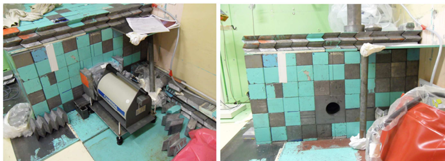
Figure 6-8 : Solutions provisoire (à gauche) et définitive (à droite) pour la reconstitution de la paroi de l'enceinte
