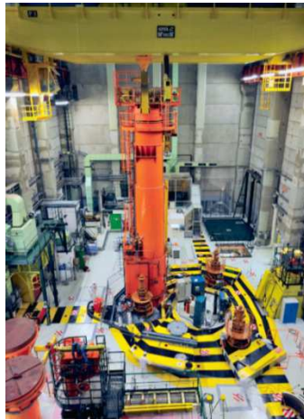
Figure 2-9 : Hotte de manutention des gros composants de PHENIX
