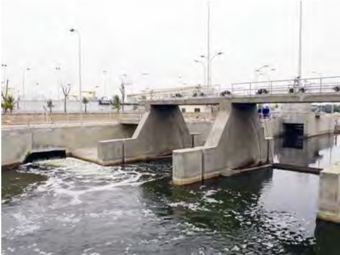
Figure 5.11 : Usine de traitement des eaux usées Yen So
