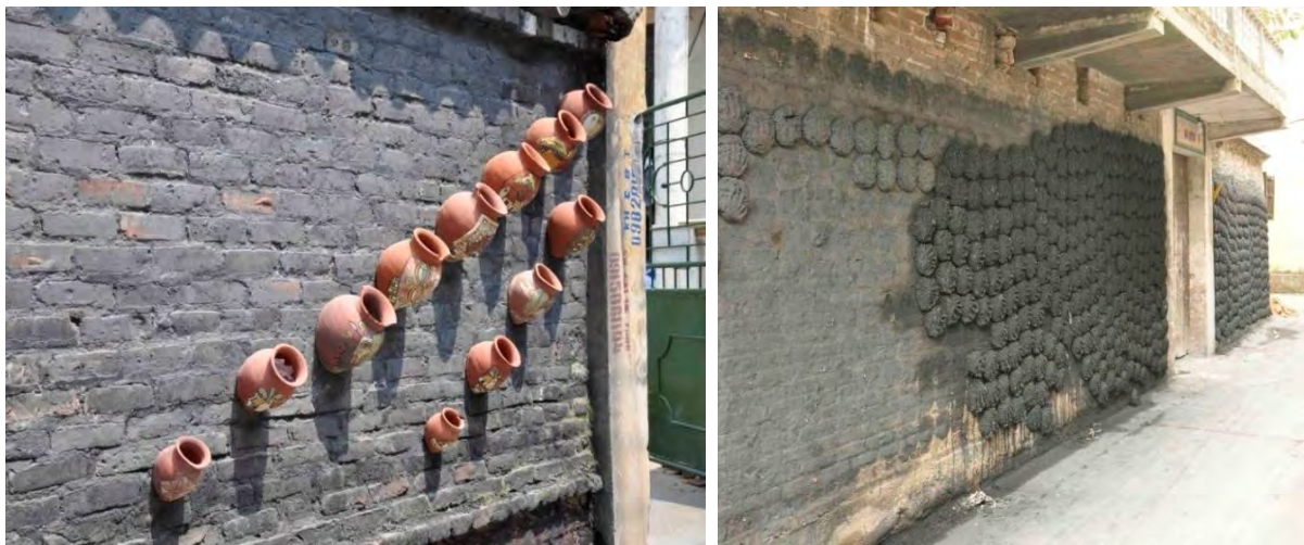
Figure 8.22 + 8.23 : La décoration à l'extérieur avec les sous-produits et les morceaux de charbon Source : enquête de terrain 2011
