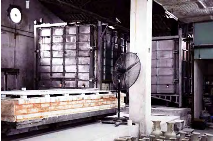
Figure 8.14 : Le four à gaz d'une unité de production à Bat Trang Source : enquête de terrain 2011
