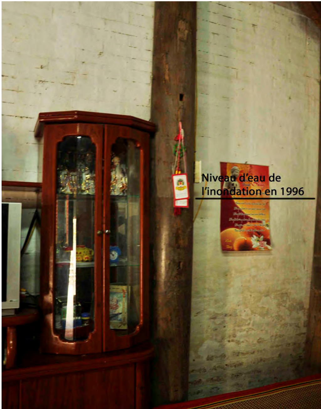
Figure 8.38 : Le niveau d'eau très haut de l'inondation en 1996 est bien marqué dans une colonne d'une ancienne maison dans l'ancien hameau de Bat Trang Source : enquête sur terrain 2013
