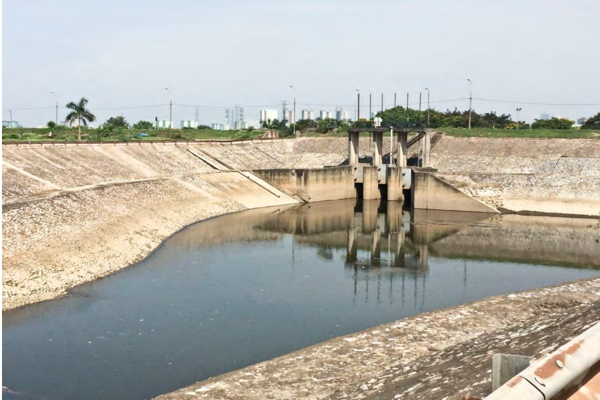
Figure 7.9 : L'égout de l'usine de traitement des eaux Yen So
