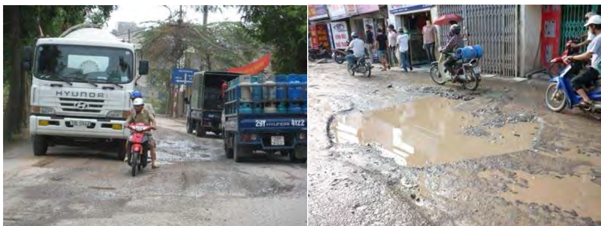
Figure 7.21 +7.22 : Le mauvais état de la rue Linh Nam Source : enquête de terrain des étudiants de l'ESGC en 2012
