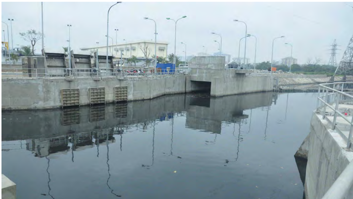
Figure 3.33 : L'usine de traitement des eaux usées Yen So
