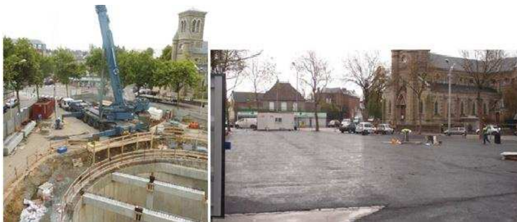
Figure B-3. Vue générale du bassin du Docteur Leveque –Le Havre- pendant les travaux et après la remise en état (site de l'entreprise Quille-Construction)
