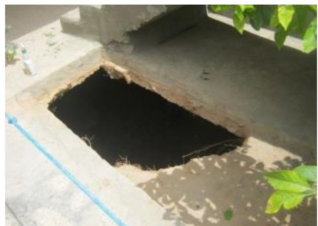
10.2. Effondrement des habitats
