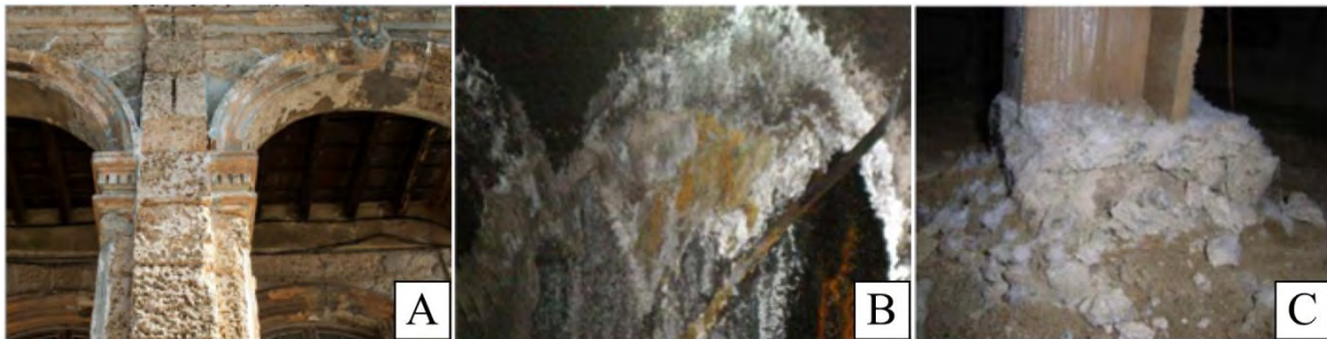
Figure 2.53 Illustration de la dégradation d'ouvrages par cristallisation de sels : Façade de bâtiment à Cuba (A) [148], Tunnel de chemin de fer en Chine (B) [149], Fondation de bâtiment résidentiel au Japon (C) [150].
