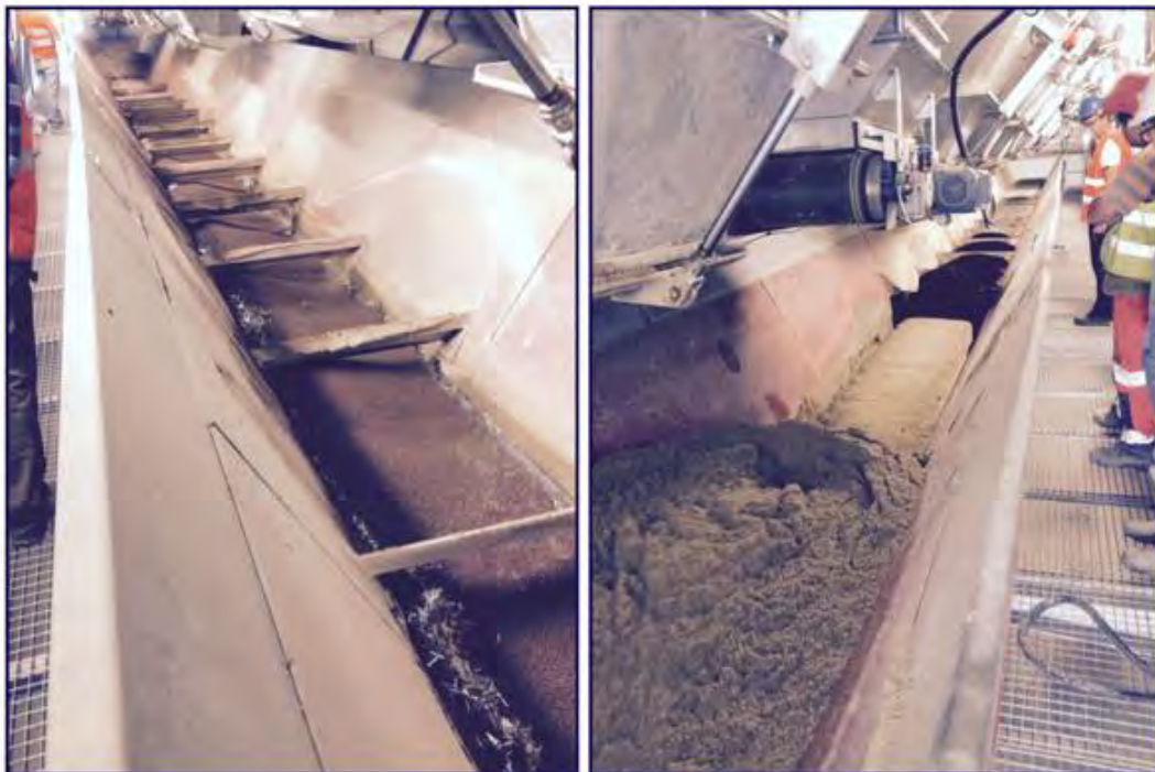
Figure 1.45 Introduction manuelle des billes d'argile et des granulats en caoutchouc en centrale BPE
