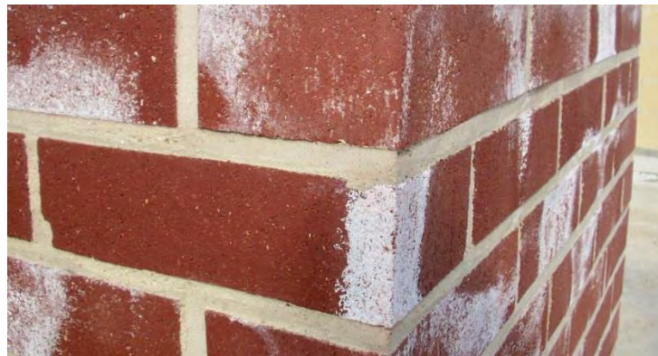
Figure 2.55 Illustration d'efflorescences à la surface d'un mur en briques (Biallais)
