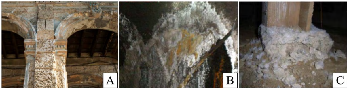
Figure 2.53 Illustration de la dégradation d'ouvrages par cristallisation de sels : Façade de bâtiment à Cuba (A) [148], Tunnel de chemin de fer en Chine (B) [149], Fondation de bâtiment résidentiel au Japon (C) [150].
