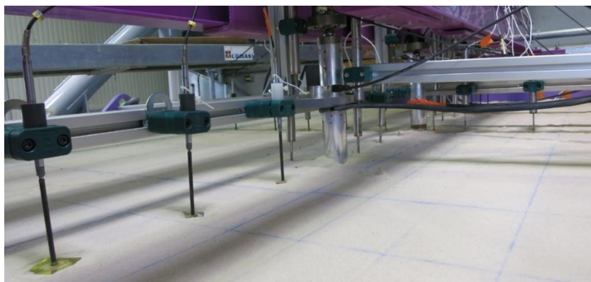
Figure II-31 – Capteurs de déplacements de la surface du sol
