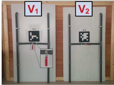
FIGURE 3.19 – Vannes à inspecter
