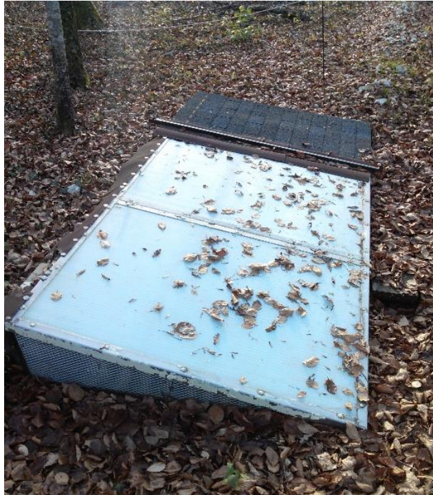
Photographie 10 – Fosse de réception des solutions dans une sous-station du site expérimental de Montiers.
