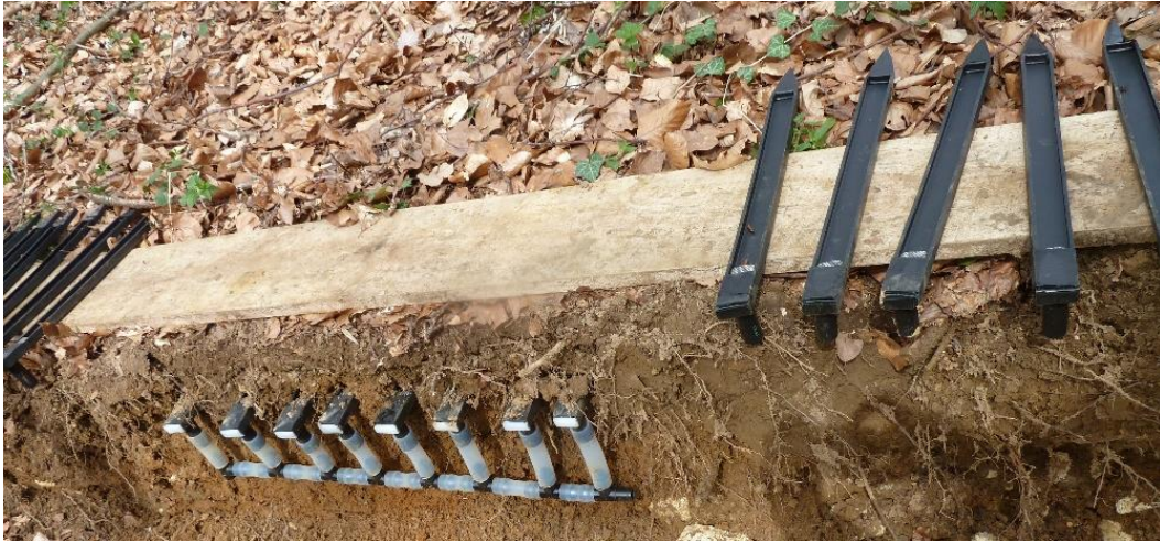
Figure 14 – Installation des flûteaux (lysimètres sans tension) dans une station expérimentale de Montiers.
