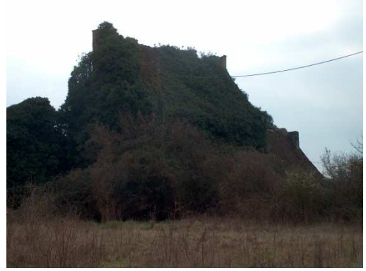
Figure 14 : Façade nord de La Vacherie à Vivoin recouverte par la végétation
