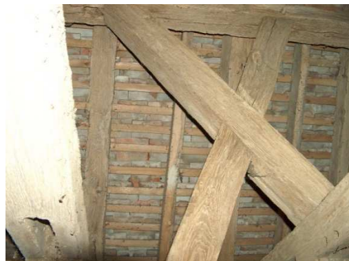
Figure 176 : Croix de Saint-André à La Corbinière à Mézières-sous-Lavardin
