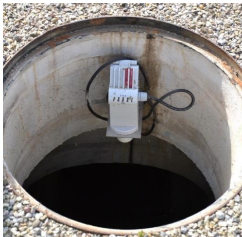
FIGURE 43: SONDE A ULTRASON A L'AMONT DE LA MARE DE SEDIMENTATION
