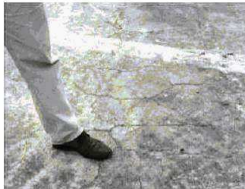
Figure 1- 14 : fissuration de la face supérieure d'un tablier de pont (Torrenti, 2012).
