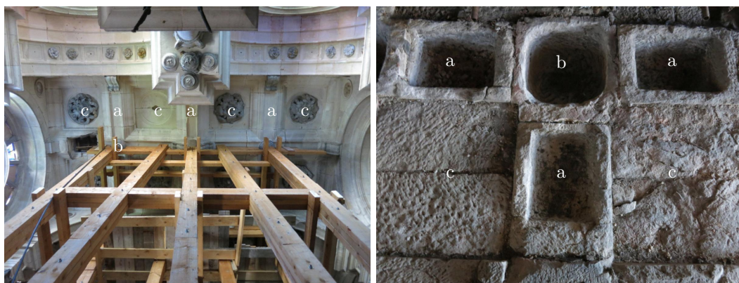
Fig 10.6 – Voûte plate dallée de la chapelle des Évêques de la cathédrale de Toul ; vue de dessous de la voûte étayée (à g.) et vue de détail de l'extrados (à d.) ; claveau courant d'un arc doubleau (a), claveau à l'intersection de deux arcs doubleaux (b), dalle en deux parties (c)
