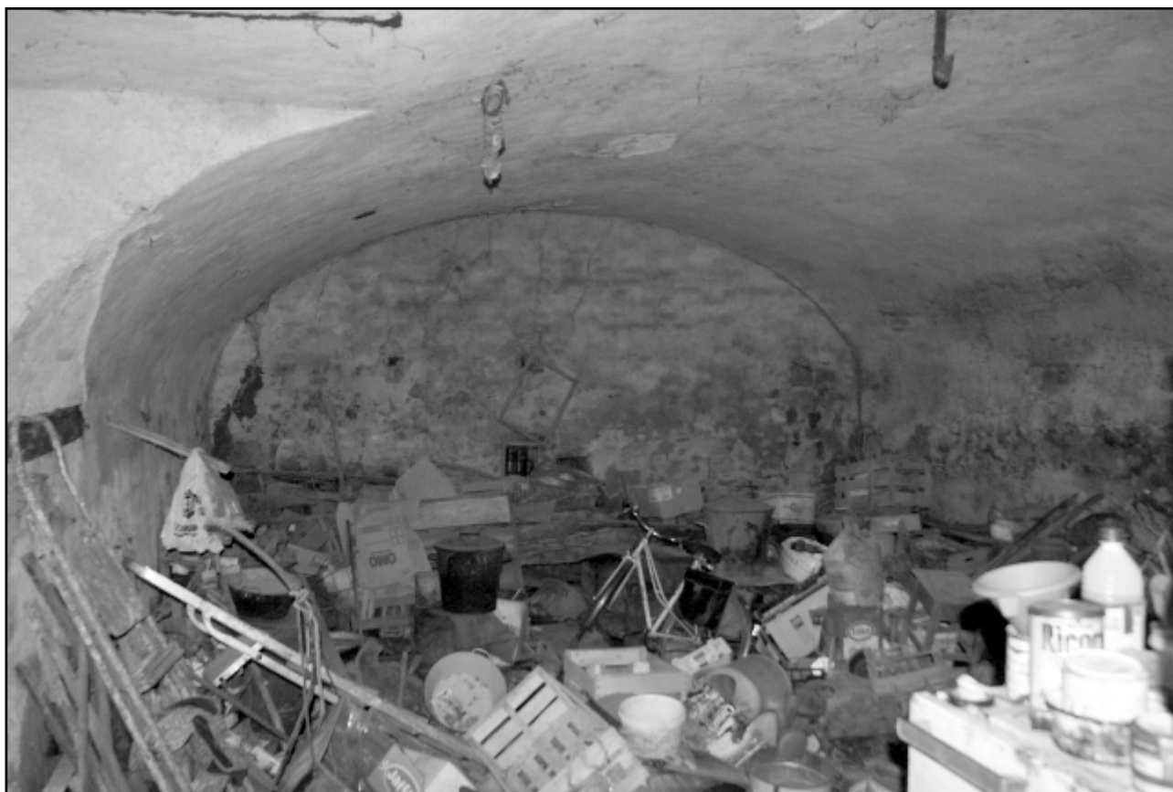
Doc. 41. Vue de la cave voûtée sud (cave 1), prise depuis la porte de la façade sud. Photographie S. A., 2013.
