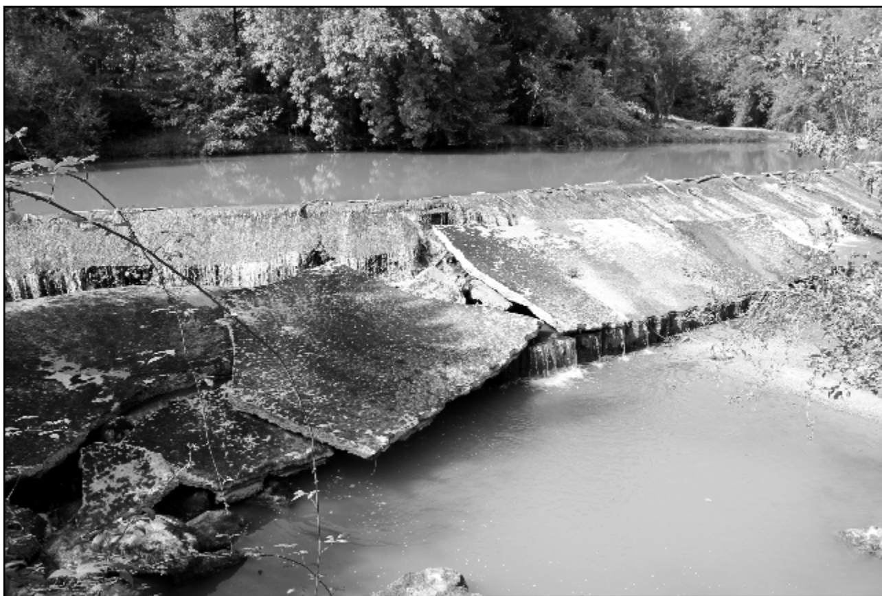
Doc. 256. Le mur-digue en amont du moulin de la Casedieu à Plaisance . Photo S. A., 2013.
