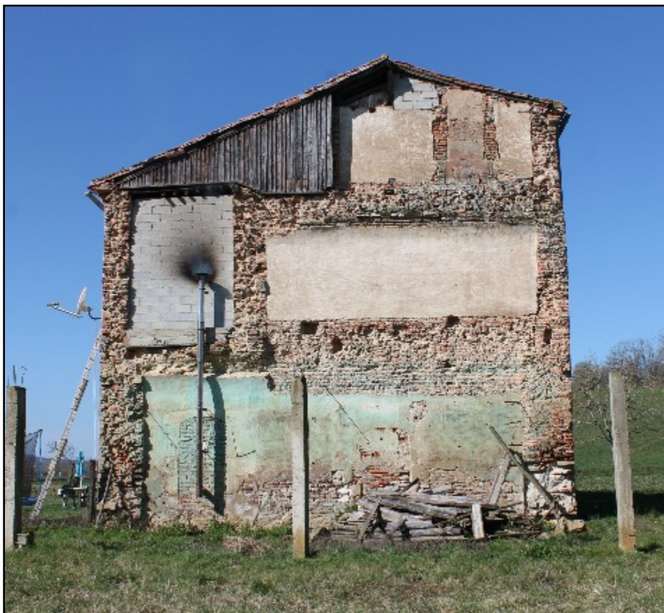
Doc. 35. La Casédie, Bâtiment A, façade est. État en février 2015. Photographie S. A., 2014.
