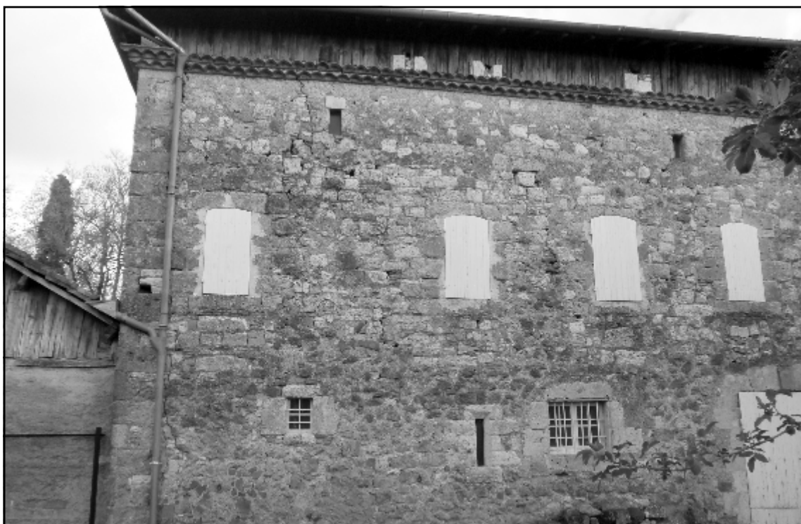
Doc. 246. Le mur ouest du prieuré (XVII e siècle), remployant des moellons médiévaux, avec à l'étage les fenêtres des cellules individuelles des chanoines à l'époque moderne. Photographie S. A., 2014.
