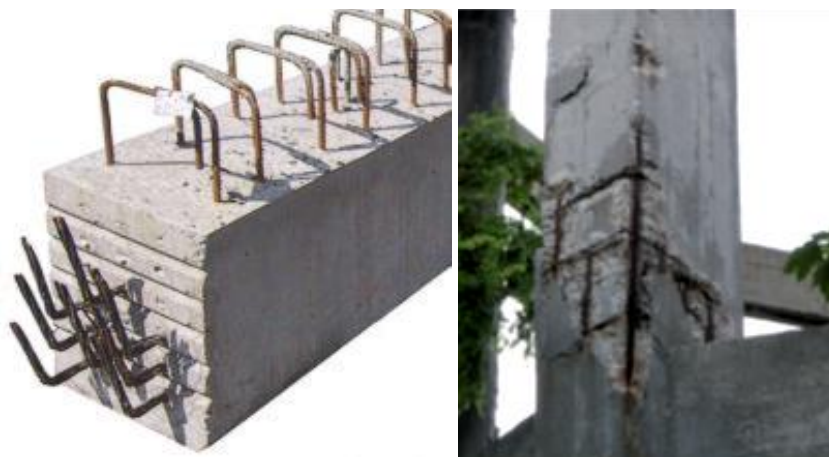
Figure 4– [a] Poutre en béton armé (source libre) et [b] Fissuration causée par le sel marin [34]
