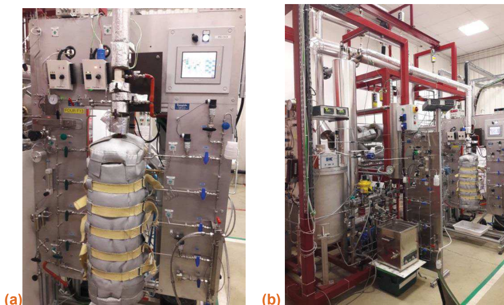
Figure 5.12 : Installation des essais : CC (a) et Boucle ESTHER (b)
