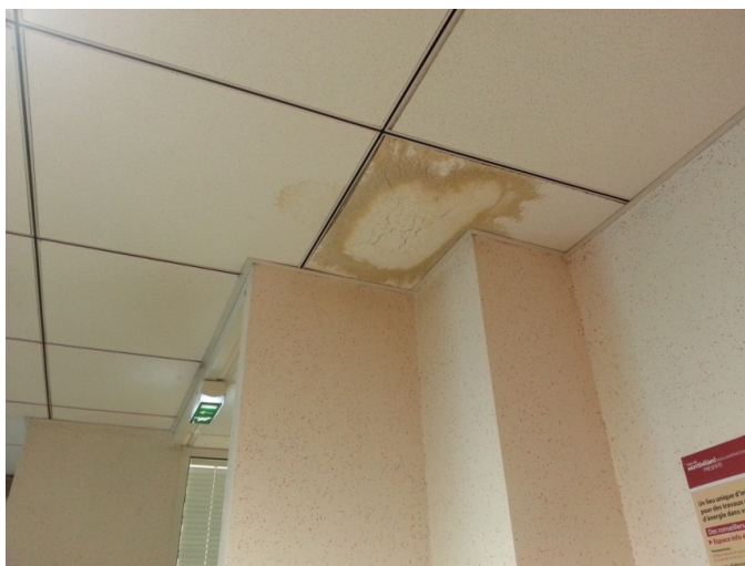
FIG. 4.8: écoulement d'un toit dans un établissement public.
